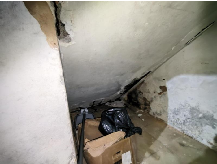
Figura 07. Vista inferior da escada principal com danos na argamassa de recobrimento e armaduras expostas com corrosão. (29/08/2022)
