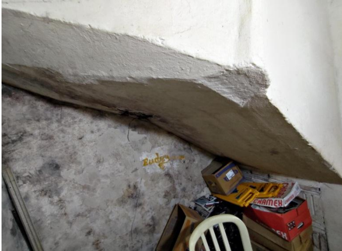
Figura 13. Vista inferior da escada secundária com danos pontuais que necessita de uma intervenção para recuperação. (29/08/2022)
