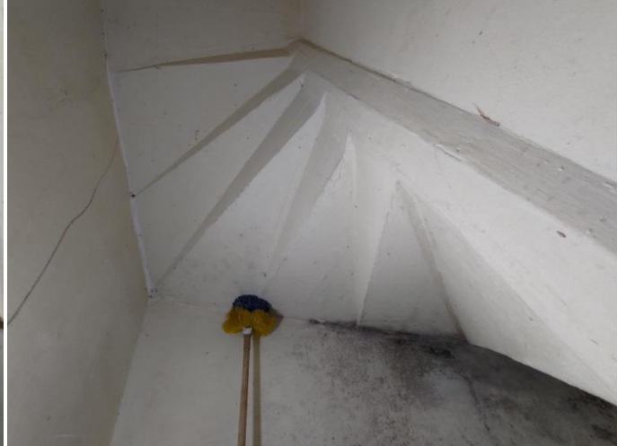
Figura 14. Vista do ambiente abaixo da escada secundária com paredes mofadas. (29/08/2022)
