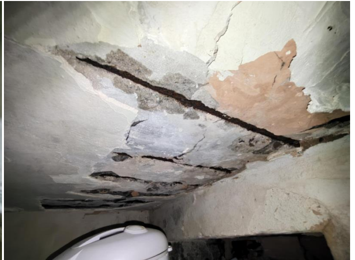
Figura 08. Vista inferior da escada principal com armaduras expostas e apresentando corrosão. 29/08/2022)
